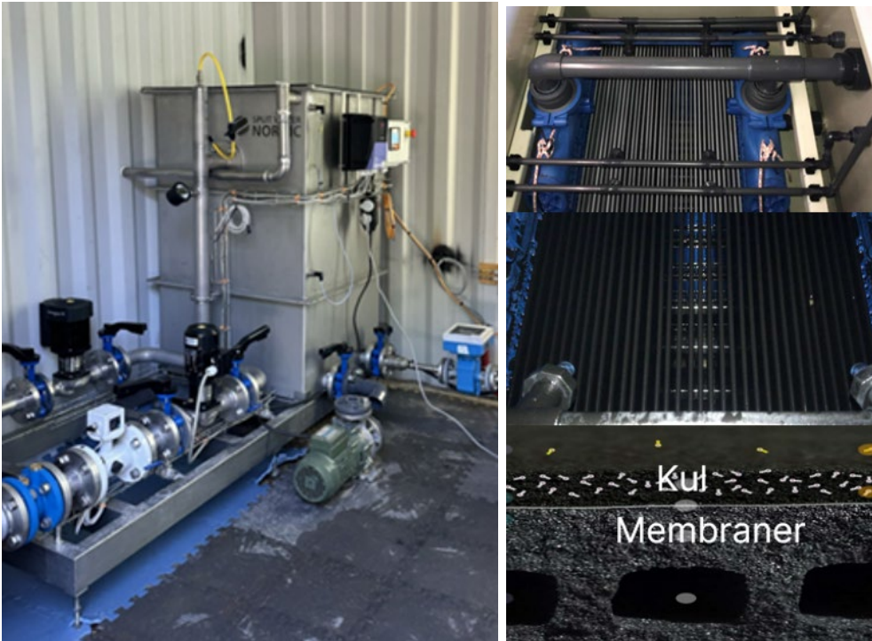
Figur 5: Split Water Nordic pilotanlæg på Solhøj Kildeplads (tv) og et indblik filtermodulet med keramiske membraner og PAC (th).
