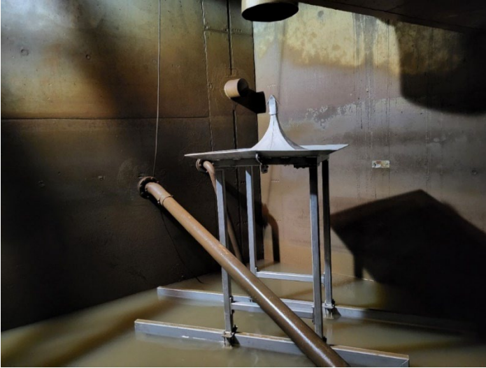
Figur 8 Den installerede vandspreder på Nibsbjerg Vandcenter.
