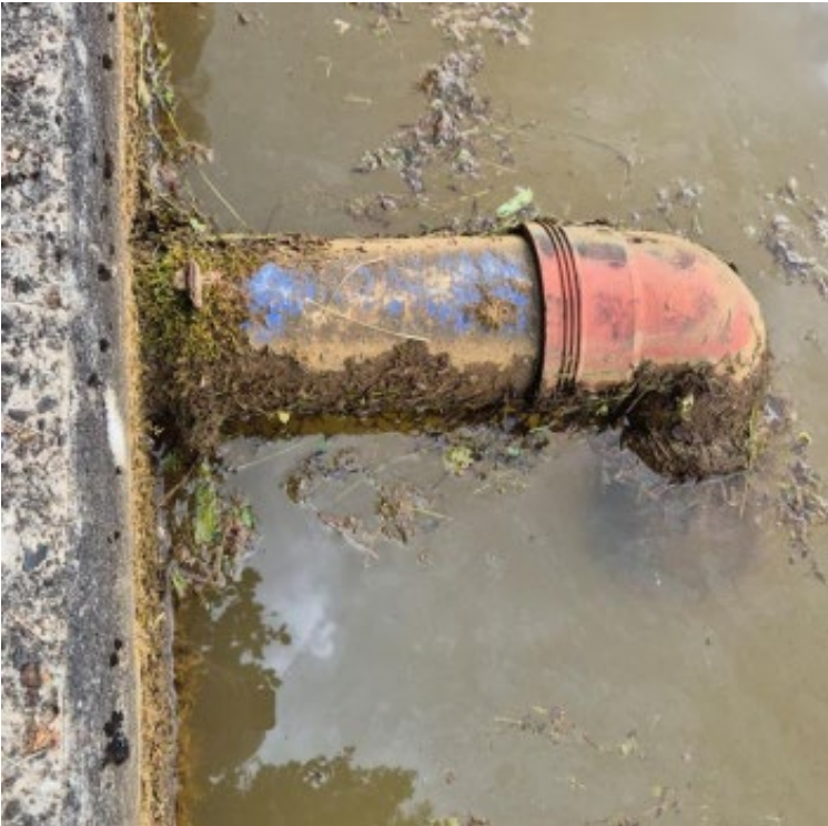
Figur 8 Punktform: Udløb bestående af et dykket rør i bestemt niveau med albue nedad.
