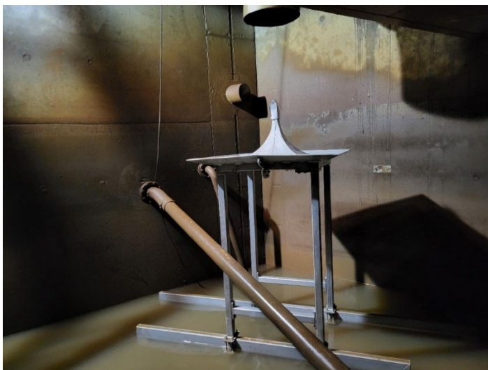
Figur 38 Vandspreder i skylletanken ved Nibsbjerg Vandcenter.
