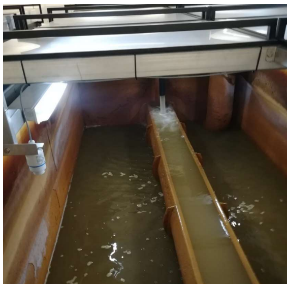
Figur 5 Skyllerenden i Filter 6, hvorfra indløbsvandet fordeles.
