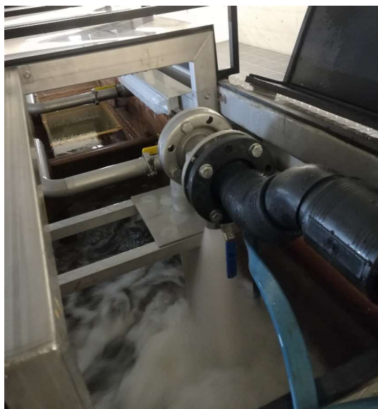
Figur 4 Plask i Østerbyværkets iltningsspor. Denne plask medførte ekstra iltning af råvandet og var forårsaget af en retursløjfe på den dykpumpe, der forsyndte SmartFilter-Fe med råvand fra iltningssporet.
