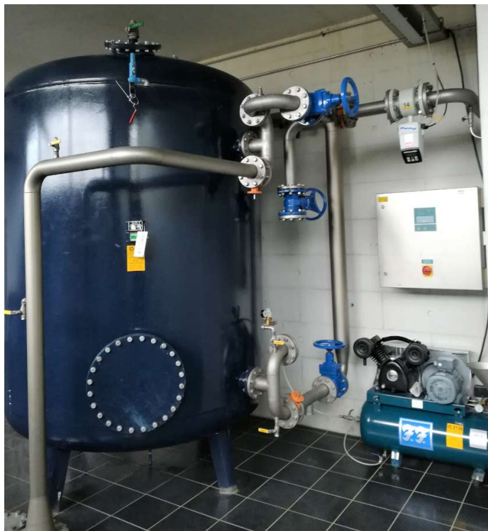
Figur 12 Foto af SmartFilter-Fe og rørføring omkring trykfilteranlægget efter ombygning af rørføring.
