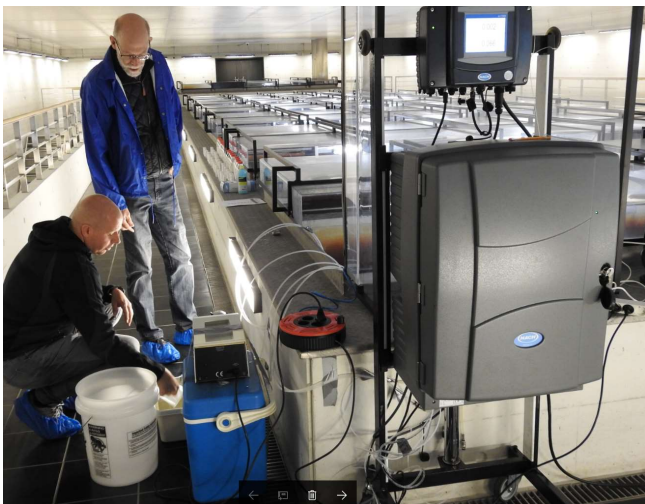
Figur 3 Amtax udstyr (til højre) til at-line måling af ammonium på Østerbyværket.
